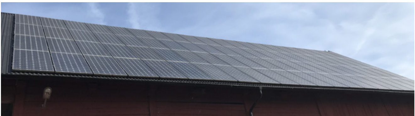
Solpaneler monterade ovanpå ett plåttak. Foto: Kristian Petersson
