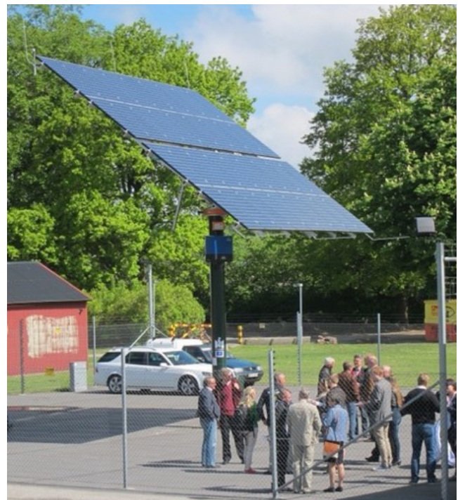
Solpaneler monterade på ett solföljande stativ. De har en märkeffekt på 11 772 kW och omfattar 36 monokristallina paneler á 1,56 m 2 med 20,4 % verkningsgrad. Årsproduktion beräknas till 18 000 kWh, vilket är ungefär 50% mer el-produktion än om panelerna varit fast monterade. För att avgöra lönsamheten måste merkostnaden ställas mot el-produktionen. Foto: Lars André
